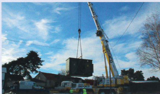
Dans le jargon de la fibre, on appelle les locaux techniques des « NRO » pour Nœuds de raccordement optique.
