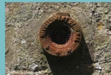
Repère de nivellement, moulin de Sauqueville. ©C. Kollmann - Inventaire général Région Normandie.
