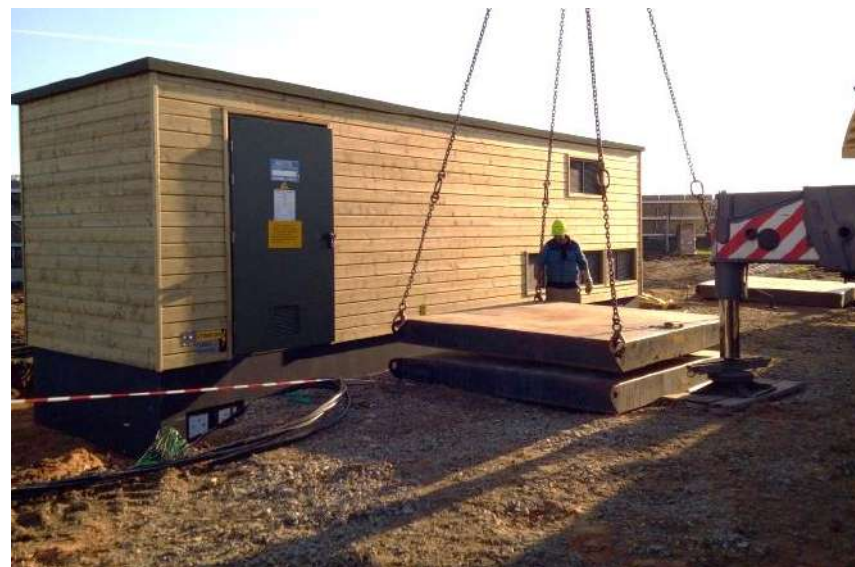
Figure 4 : Exemple d'un poste de livraison (photo prise en phase chantier Source : IEL)
