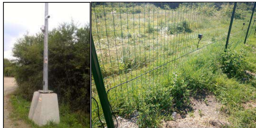
Figure 40 : Système de vidéo-surveillance infrarouge (gauche) et par câble de détection (droite) (Source : centrales solaires d'IEL à Machecoul (44) et à Descartes (37))
